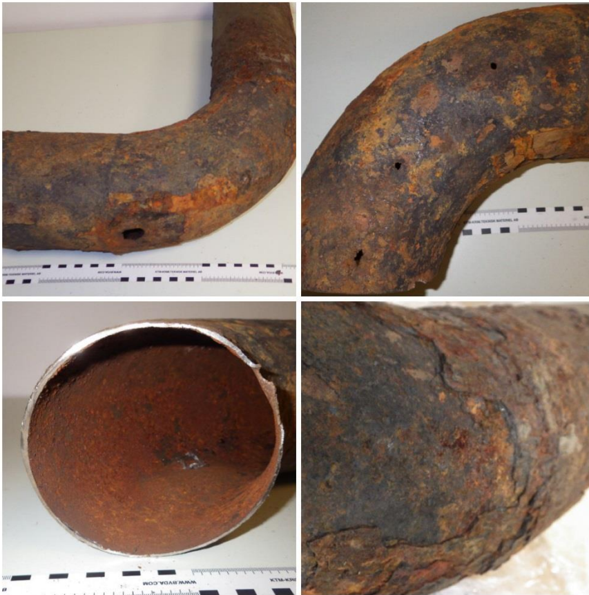
Foto 3: Korrosiooni tagajärjel kahjustunud kütusetanki MDO-2 ventilatsioonitoru
